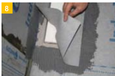
8 ... d'étanchéité DiProtec® FIX-MSP. Le collage de la collerette d'étanchéité IndorTec® SEAL-RM sur la bande d'étanchéité s'effectue à l'aide la colle d'étanchéité IndorTec® SEAL-DK. Positionner la collerette et appuyer pour éliminer les bulles d'air.
