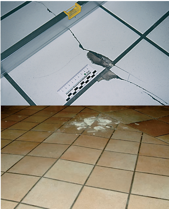
Les contraintes au cisaillement dues à des coefficients de dilatation différentes du revêtement et du support ou en raison de chapes récentes encore en rétraction conduisent à des fissures ou bombements du revêtement.
