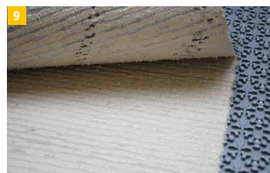
9 Somit wird eine vollflächige Einbettung zum Untergrund erreicht. Weiterführende Arbeiten erfolgen nach Erhärtung der Verklebung von IndorTec® THERM-E.
