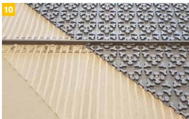
10 An Bauwerkstrenn- und Bewegungsfugen sind die Trägermatten zu trennen. Die Ausbildung der Fugen erfolgt nach Vorgaben der Regelwerke und Herstellerverlegeschriften der entsprechenden fließfähigen Bodenspachtelmasse und des Bodenbelages.
